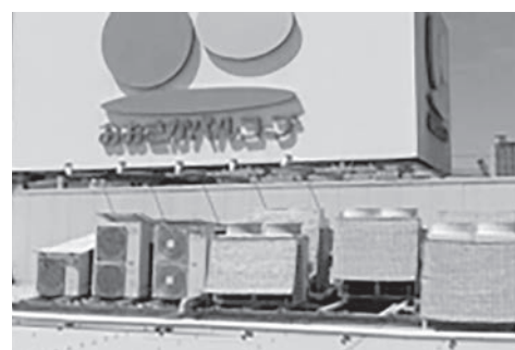
西くずは店の遮光設備
