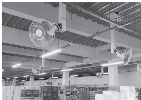
支所倉庫の扇風機（門真支所）
