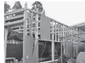
作業場の屋根などがめくれて破損
